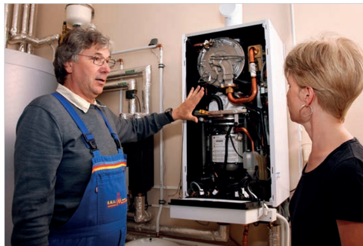
Mit effizienter Technik kann man gegenüber früheren Heizungsanlagen bis zu 30 Prozent Energie einsparen. Foto: Allianz Freie Wärme/BDH/TRD Energie und Umwelt/akz-o
