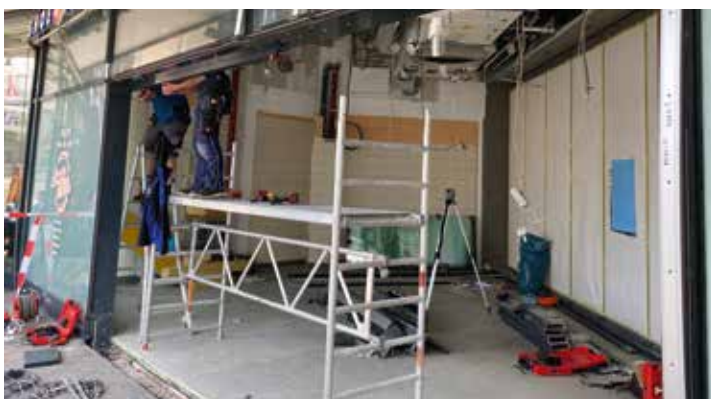
Noch haben die Handwerker das Sagen. Aber schon im Sommer soll der neue Grill-Imbiss der Fleischerei Lange öffnen. Foto: büro v.i.p.
