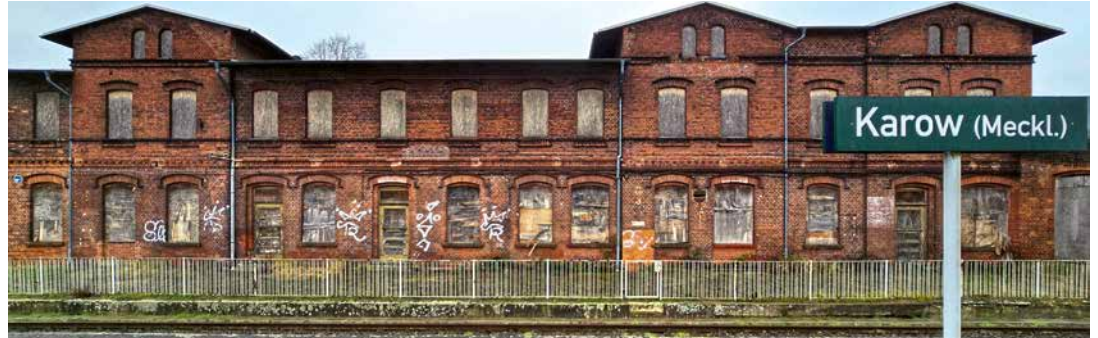
Heruntergekommen, aber nicht abrisstauglich: Der Bahnhof Karow besteht aus roten Ziegeln aus dem Karower Meiler.
